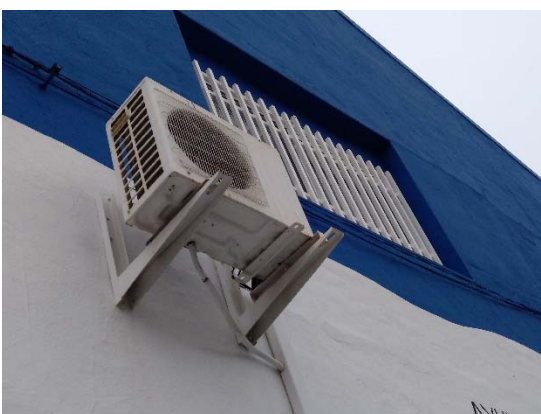
Imagen 11. Unidad exterior Brignton
