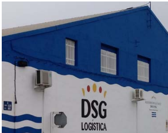
Imagen 7. Unidades exteriores de equipos de climatización de planta baja
