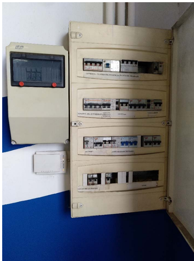
Imagen 14. Cuadro eléctrico general de baja tensión
